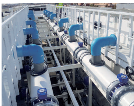
Sistemas de condensación.
